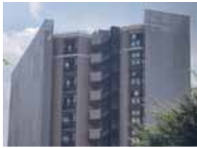
2020年8月 東京都 ザ・パークハウス 三鷹レジデンス 外壁一部 施工面積：100㎡
